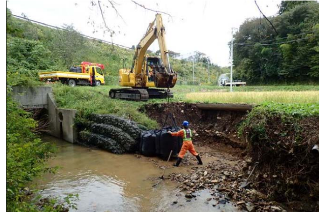
気仙沼地区河川洗掘対応(10/12)
