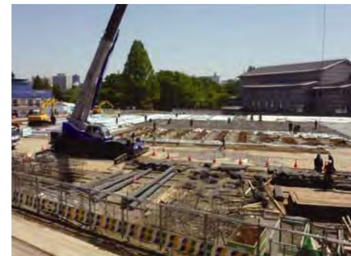
国連世界防災会議のメイン会場となる仙台国際センター展示棟建設工事の現場。
