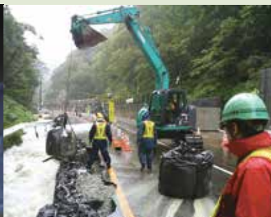
R48 県境付近仮設道路法面崩落対応
